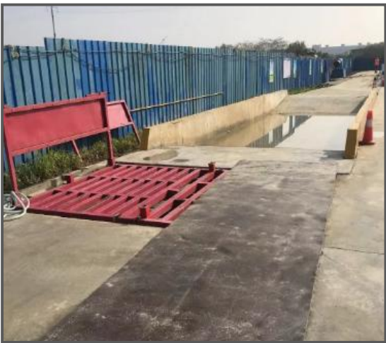
洗车平台、洗车池
